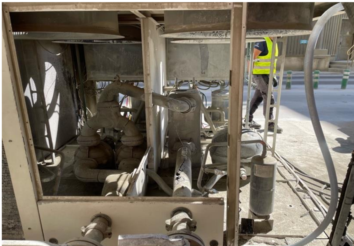
Vue de derrière : partie hydraulique visible.
