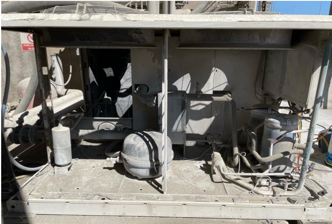
Vue de coté : partie fluide et hydraulique visible.
